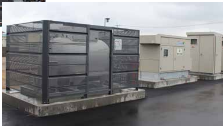
災害バルク貯槽と非常用発電機
