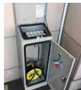
非常用コンセントボックス
