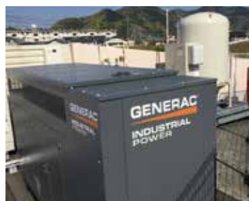
屋上に設置した 災害バルク貯槽と発電機
