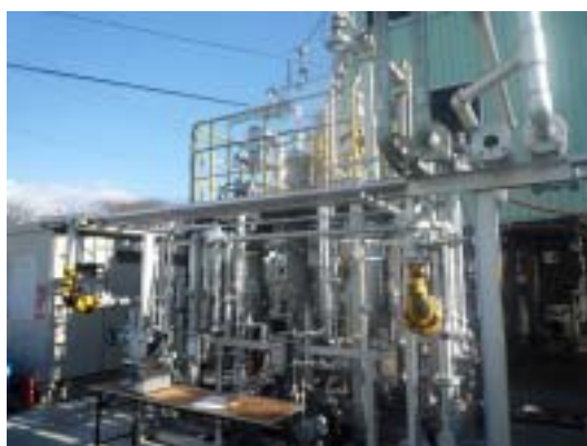
【バイオマスガス化設備(※1)】
