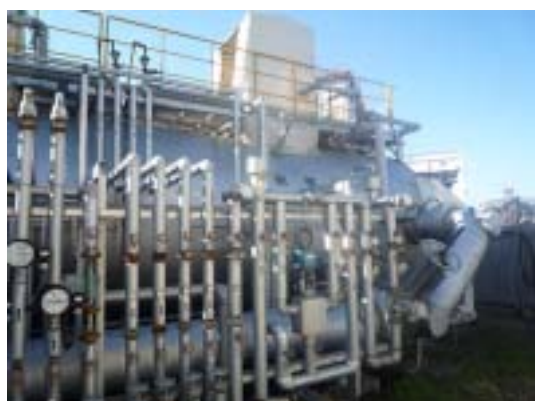
【高温メタン発酵槽(※1)】
