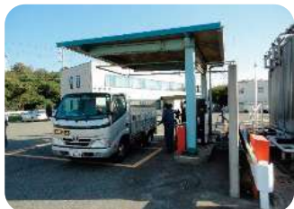
LPガス自動車充填設備
