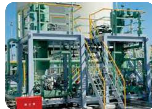
熱量調整装置(出典:九州ガス圧送 株)
