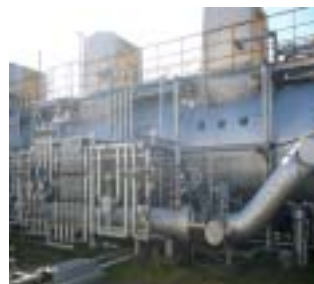
京都バイオプラント/高効率メタン発酵設備発酵槽
