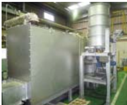
長崎農林バイオマス3号機実証プラント/ガス化設備
