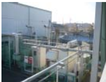
京都バイオプラント/高効率メタン発酵設備全景
