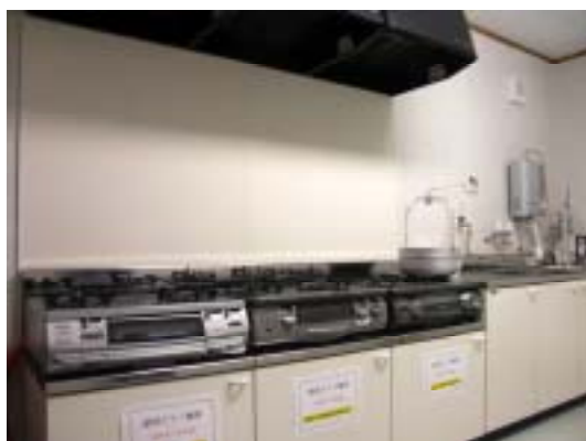
実験棟内の耐久試験機器 (厨房:コンロ・湯沸かし器等)
